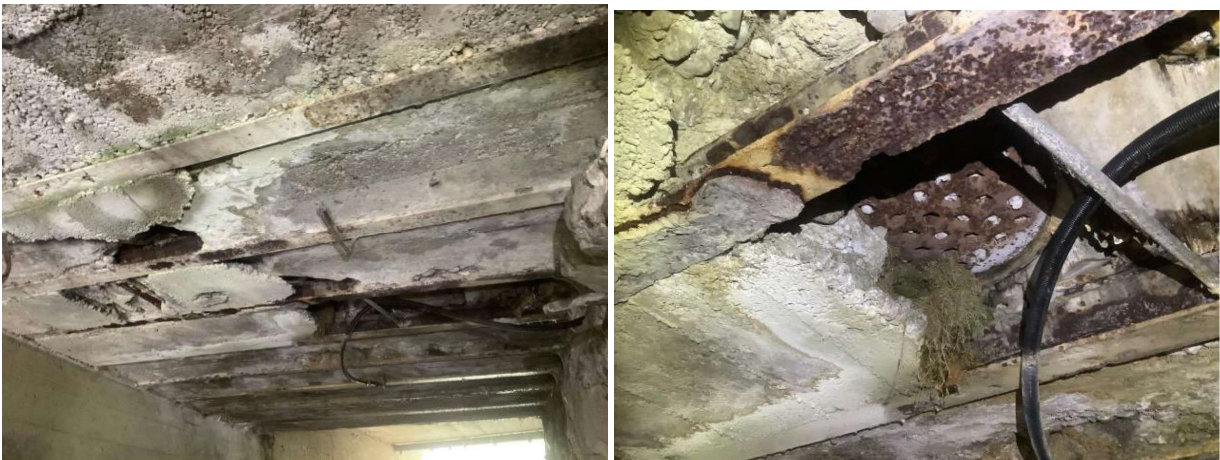
Abbildung 2: Brückenplatte Vorplatz Privat (Quelle: Bericht Hauptinspektion)
