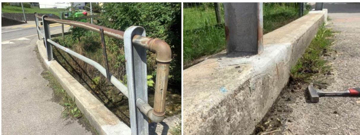
Abbildung 5: Geländer und Belag Brücke Gemeinde (Quelle: Bericht Hauptinspektion)
