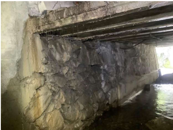
Abbildung 1: Widerlager Vorplatz Privat (Quelle: Bericht Hauptinspektion)
